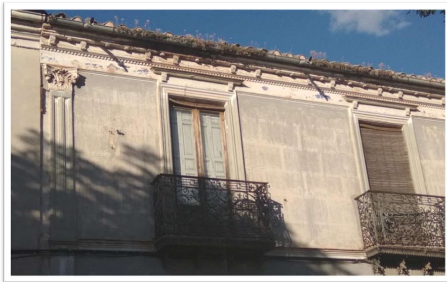
Fig.9: Elementos decorativos que coronan las Casa- Bodega del Paseo de la Estación de Valdepeñas.
