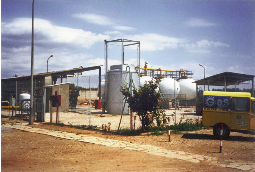
Figura 2. Planta de aire propanado de Reus
