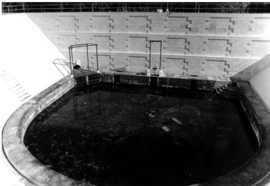
Figura 2. Taza de captación en Vento
